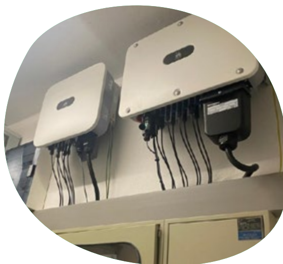
Inversores do sistema fotovoltaico, no Palácio
