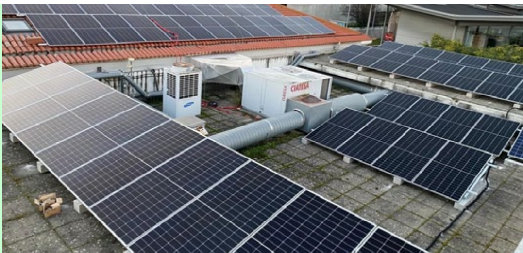
Painéis solares, no PAB
